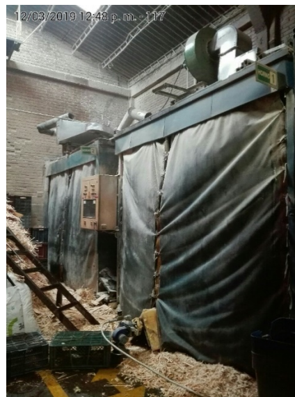
Fotografía 6: Cámaras de secado de madera.
