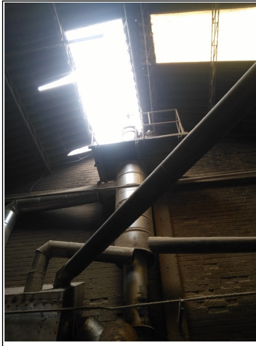
FOTO 4. DUCTO CALDERA 10 BHP
