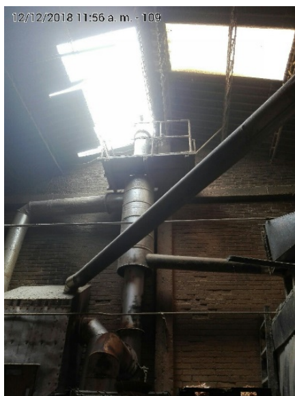
Fotografía 5: Ducto y plataforma caldera 10 BHP. Tomado del CT 1395 del 22/02/2018
