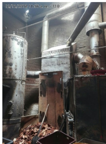
Fotografía 4: Sistema de control – multiciclón Tomado del CT 1395 del 22/02/2018
