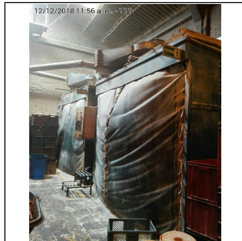
Fotografía 6: Cámaras de secado de madera.
